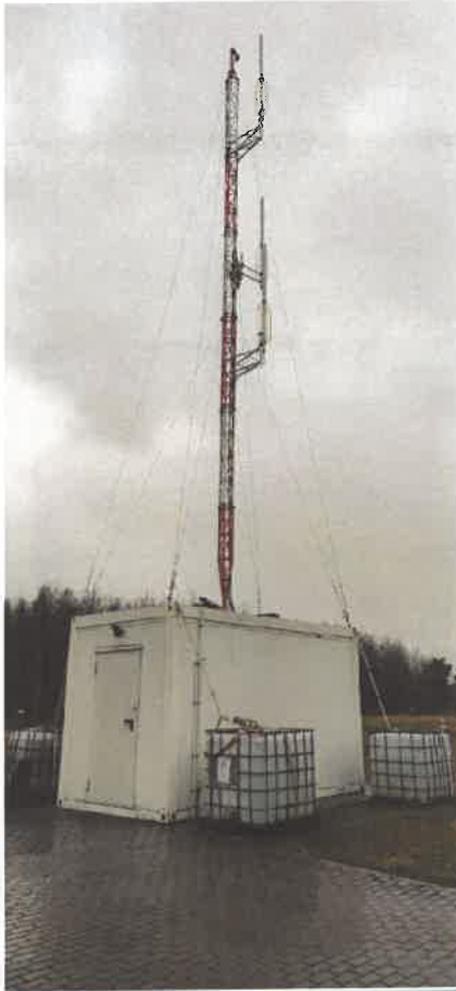
KONTENER TELETECHNICZNY NR 54 – wysokość ok 8-9 m
