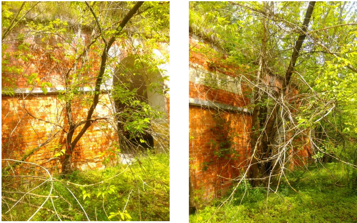
Rys. 10. Przykład wrosniętych drzew w ścianę budynków.
