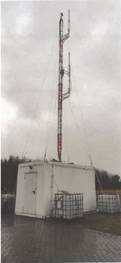
KONTENER TELETECHNICZNY NR 54 – wysokość ok 8-9 m
